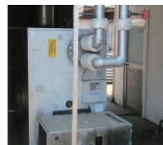
旧設備 温水ボイラ
