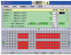
制御盤 スケジュール運転
