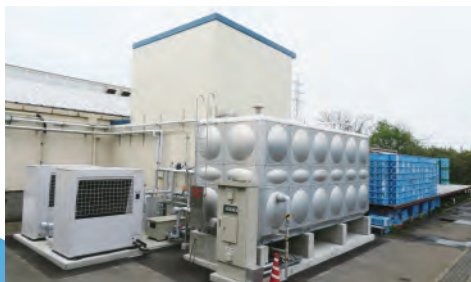
新設備 産業用エコキュートシステム
